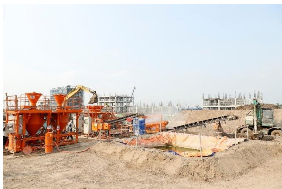
管路処理システム全景
